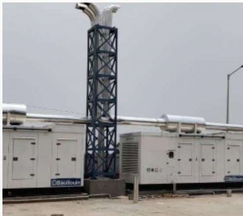
Walmart Project 500 kVA x 3
