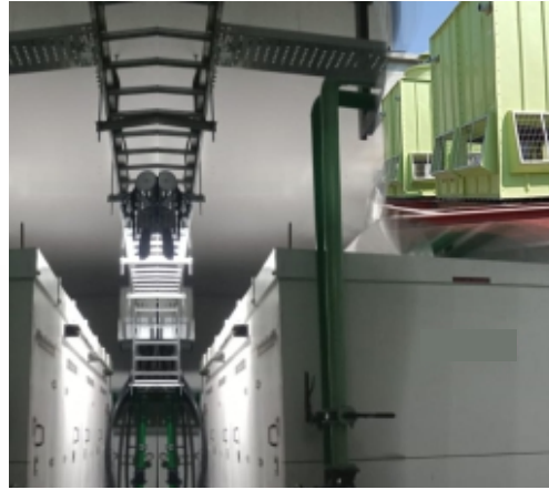
Hyatt Project 625 kVA x 2
