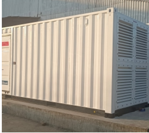
Container DG set 1000 kVA to 1500 kVA
